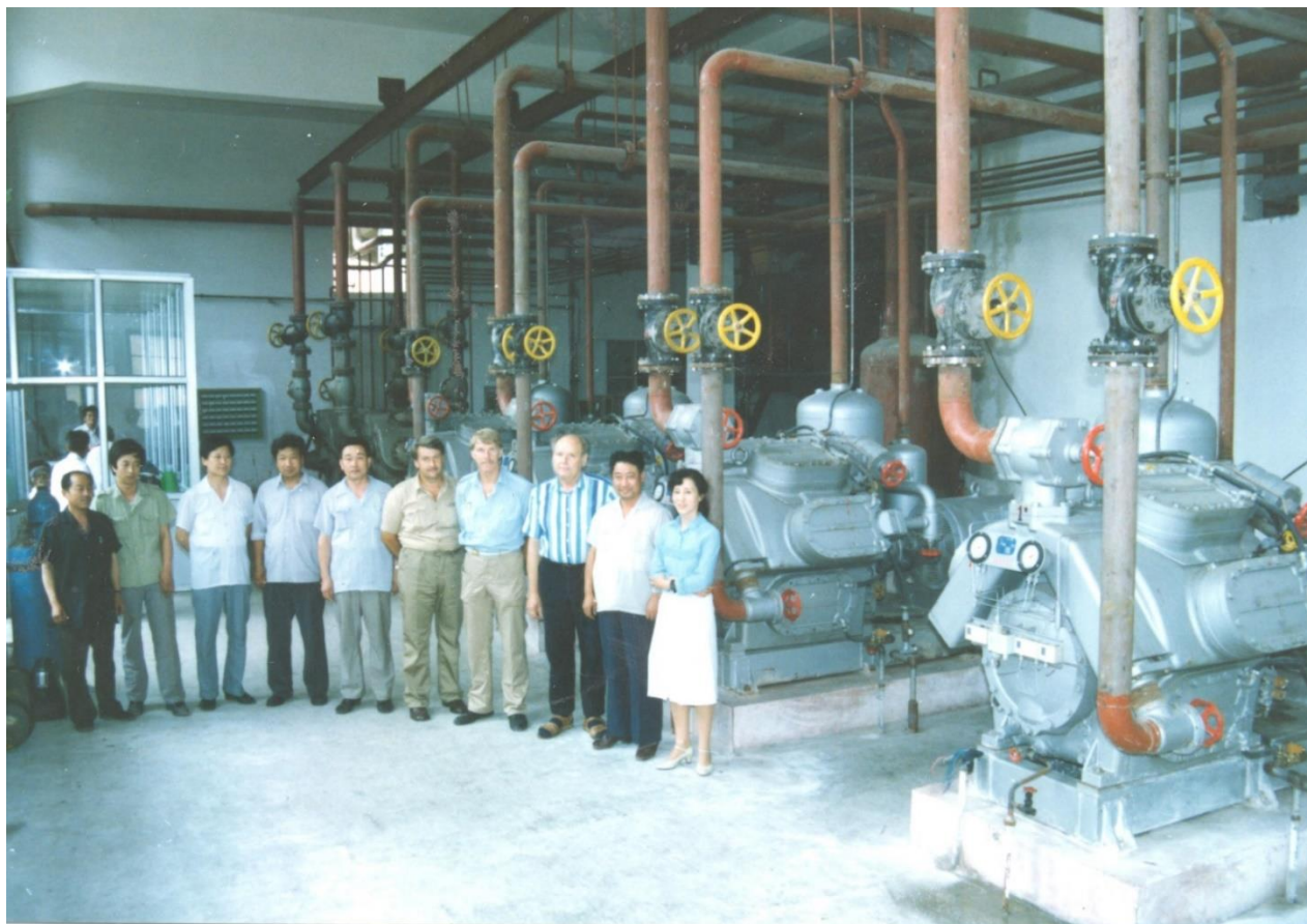
Kina – 1987. Nyt frysehus med kompressorer TSMC 180 fra Sabroe, leveret til Dalian Fishery Industry Corporation. På billedet som nr. 1 til højre køleingeniør Madame Gao Gun. Nr. 3 er forfatteren, nr. 4 maskinmester og supervisor Helge Weinreich Johansen og nr. 5 ass. supervisor Kennet Gadeberg, alle fra Sabroe. Fotograf ukendt.
