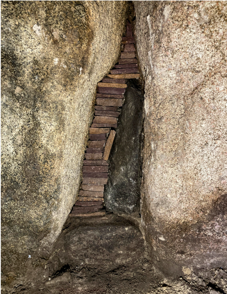
Fig. 2. Tørmursfliser i Ørnhøj. Den rødliga nuance tilkendegiver, at der her er tale om en istandsættelse med nye fliser.
