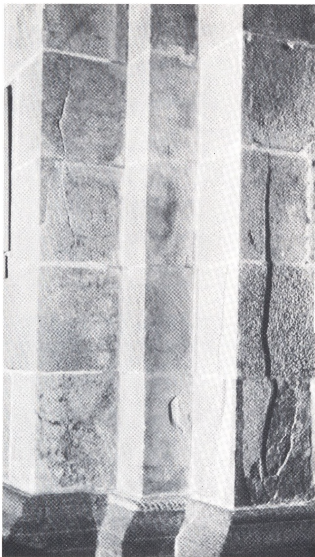
Fig. 10. Ribe domkirke. De ændrede statiske forhold, der fulgte hvælslagningen i midtskibet, gav tryksskader helt ned i arkadepillerne. Her hænger kvaderhjørnerne endnu fast, men mange andre steder er de sprængt af ligesom på Borumgavlens hjørner (fig. 11).
