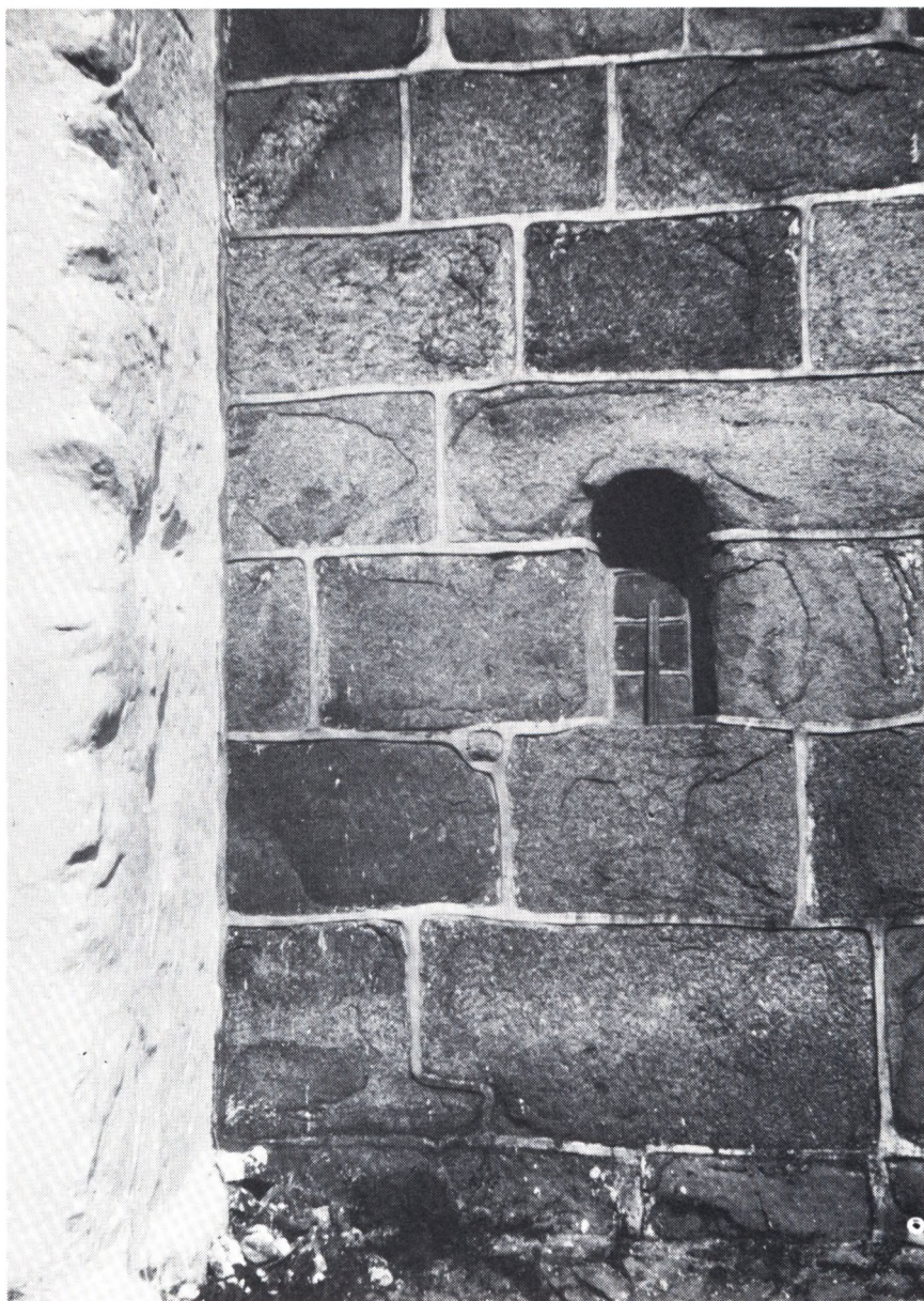
Fig. 14. Fausing kirke syd for Randers fjord. En så omfattende nedbrydning af granitkvadre er sjælden.
