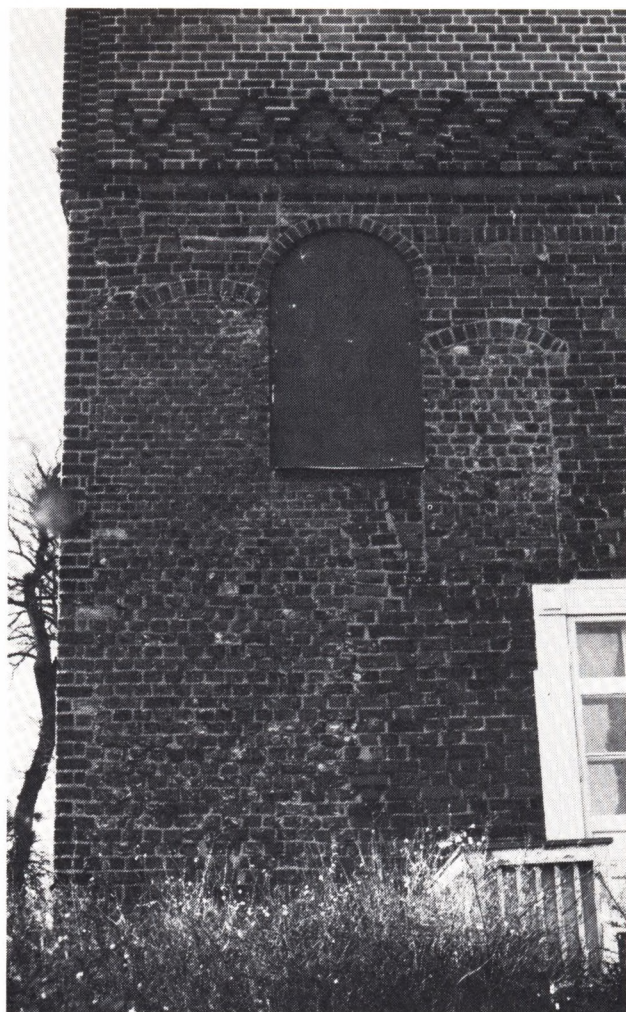
Fig. 7. Udsnit af østgavlen. I 2. stokværk ses til højre stikket og den ene fals fra et vindue, der senere er omdannet til en dør. Murværket over fladbuestikket til venstre virker uregelmæssigt, og stikket stammer vel fra det sæt vinduer, hvoraf et par også kunne ses på sydsiden. Derunder ses den store udmuring, der når helt ned til jorden. Øverst er der anvendt moderne sten – formentlig hovedsageligt kopvendte munkesten. Det blandede vindue og havedøren er fra ombygningen i 1855-56. Foto: H.K.K. 1978.
