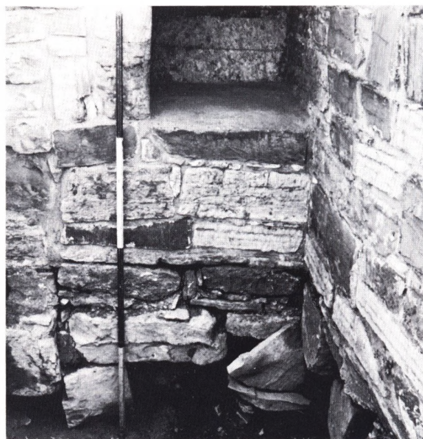
Fig. 6. Søndre transepts innvendige SV-hjørne. Til venstre for målestaven observeres en klar ståfuge i murverket. Fugen viser at transeptet er murt inn mot østfløyens eldre murverk. En stor del av steinene øverst til venstre og en god del av muren til høyre er ommurt ved restaureringer tidligere i dette århundre, noe som tilslører de opphavlige forhold. Steinene underst i muren er utbrutt ved gravearbeider i forrige århundre.
