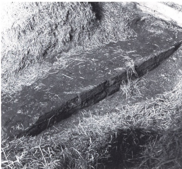
Fig. 1. At Ring kloster rummer lovende rester af det gamle benediktinske nonnekloster fremgår af dette billede fra 1972. Blot ved at flytte noget haln i avlsgårdens dastående nordfløj kunne man fotografere dette stykke fortrinligt bevarede munkestensmur fra tiden efter 1420'erne. Foto: M1-95, 1972.
