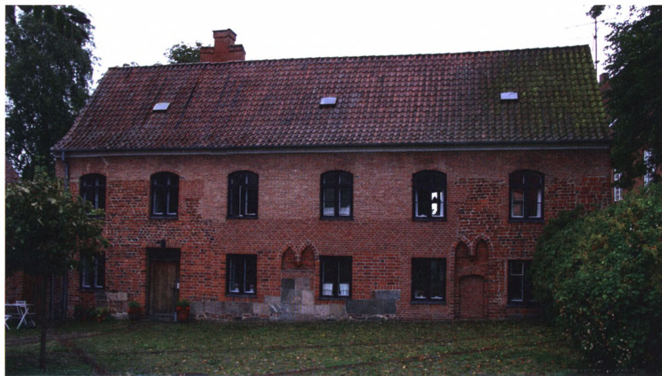
Fig. 20. Bygning G's vestfacade. Muroværket afslører gentagne ombygninger og reparationer. Foto: HKK
