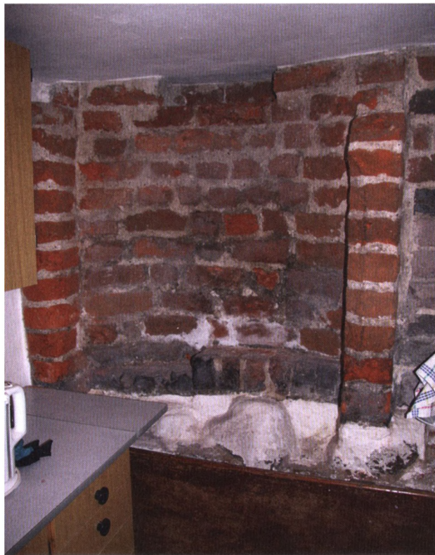
Fig. 34. Rester af en kamin i nederste stokværk i bygning J. Vangerne, bagvæggen og begyndelsen på skorstensløbet er rimeligt velbevaret. Sænkningen af etageadskillelsen har til gengæld ødelagt kaminens kappe. Foto: HKK 2017.
