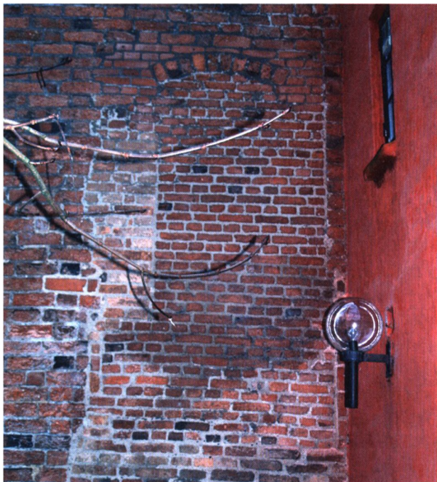
Fig. 44. Spor på nordsiden af bygning K efter den forsvundne hemmelighed. Foto: HKK 2009.
