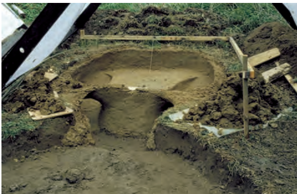
Fig. 5. Ovnbunden er beklædt med ler, og overdækning af de to kanaler er påbegyndt.
