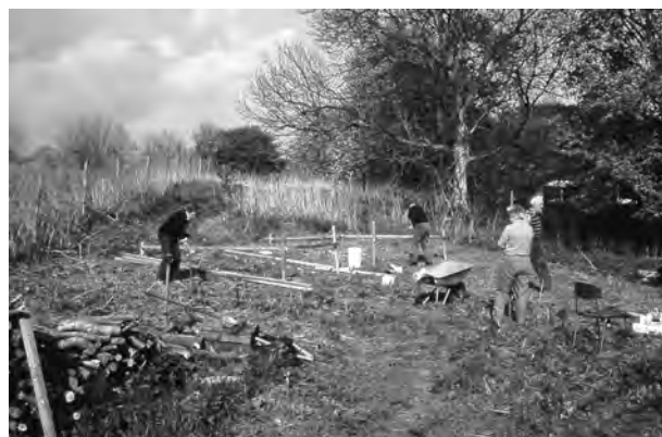
Fig. 2. En let skrånende flade blev valgt til stedet, hvor kopierne af ovnene skulle opføres. Her er målerammerne stillet op og gravearbejdet gået igang. Til venstre ses Annette Bibby og Helle Reinholdt i gang med gravearbejdet.
