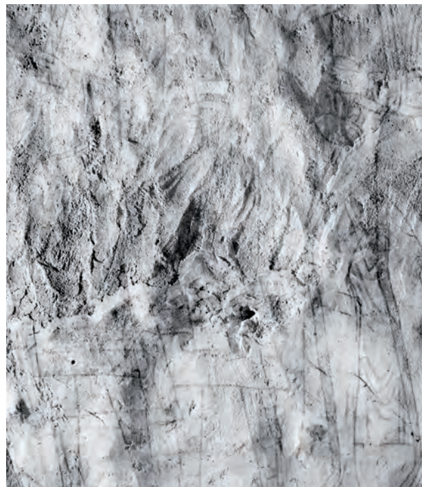
Fig. 6. Råsted Kirke 1100-1125. Udsnit jvf. fig. 4. Vandret på figuren ses en pudsoverlapning (stødfuge) i overgangen fra den glatte til den ru pudsoverflade. Foto: Peder Bøllingtoft 1998.
