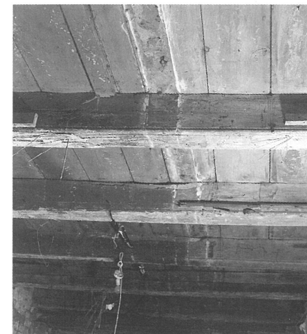
Fig. 16. Undersiden af de tværbjælker, der blev lagt ind i det middelalderlige stenhus, da dette kort før 1600 sammenføjedes med den nye bindingsværkslænge mod syd. I forgrunden bjælke 2 fra nord. På bjælker og loftsbrædder ses som to parallelle lyse streger sporet af den langsgående skillevæg i det nye gavlhuse forreste del, jvf. fig. 3. Selve vægsporet står med samme rødbrune farve som rummet mod øst, mens rummet mod vest har blågrå loftsbe-maling. Foto: PKM.
