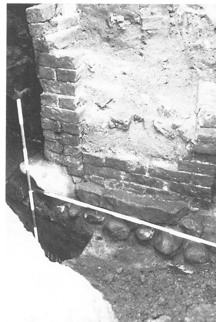
Fig. 9. Nørreports NV-gavl mur. Muren er kun 1,27 m tyk. Den store skade i gavlen skyldes et fjernvarmetræ fra 1970-erne. Under fundamentsstenen længst til venstre i billedet anes den runde egestok, som bidrog med en dendrokronologisk datering af Nørreport. Foto: Hans Skov.
