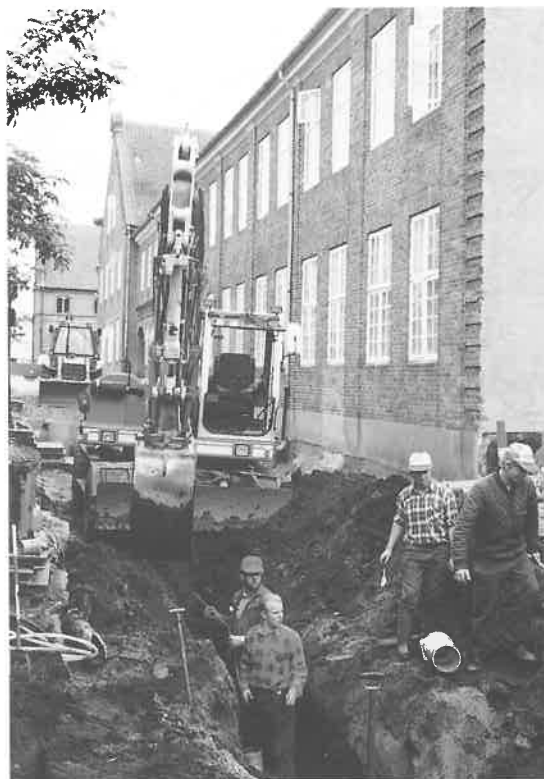
Fig. 2. Arbejdet med udskiftningen af kloakken i Vægtergade er nået omtrent halvvejs. Gaden er set fra øst. Foto: Hans Skov.
