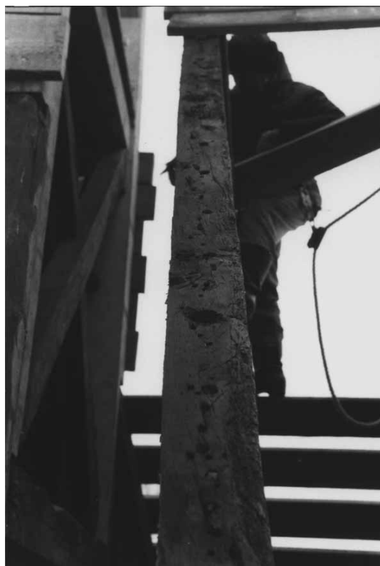
Fig. 12. Kalvslund Kirke, søndre spær i spærfag 4. På ydersiden af spæret række af naglehuller, deraf nogle med afbrudte nagler samt sømhuller efter blybrædder. Foto: PKM 1993.
