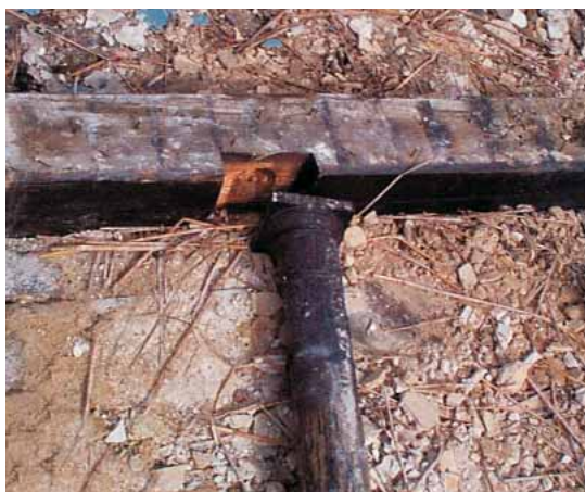
Fig. 7. Da man rev bygningen ned, fandt man foruden de enkelte synlige søjler de oprindelige støbejernssøjler gemt i skillevæggene. Her ses træbjælke og støbejernssøjle. Foto: Anker Ravn Knudsen.
