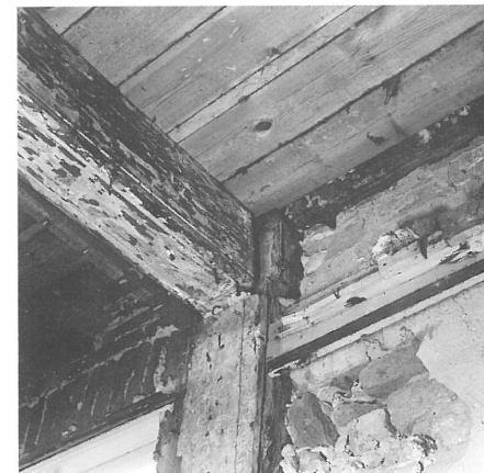
Fig. 13. Bindingsværkslængens østvæg, stolpe VIII set fra syd med rest af høvlet profilering på tværs af naglen, der holder stolpe og tværbjælke sammen. Stolpens sydside er beskåret med 4-5 cm, og på dens inderside er fastsømmet et kileformet brædt. Disse foranstaltninger har at gøre med etableringen af et bræddeloft på undersiden af de profilerede tværbjælker. Foto: PKM.
