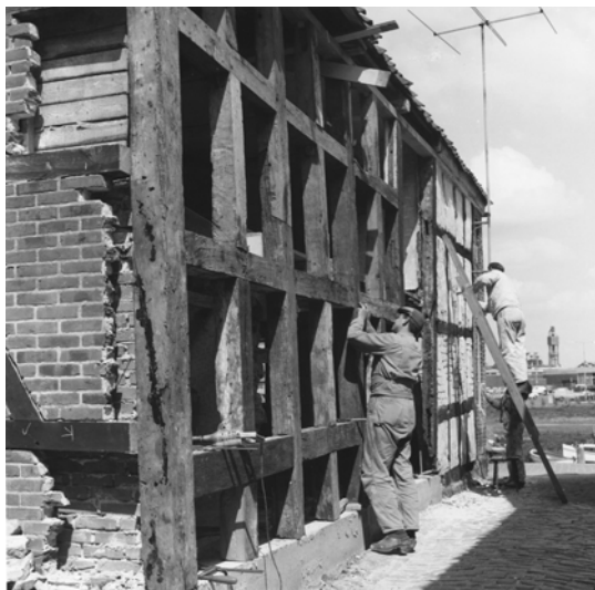
Fig. 6. Skibbroen 13, "Sælhunden". Facaden mod Skomager-slippe, under restaureringen. Store dele af bindingsværket var ødelagt og blev rekonstrueret, som det havde set ud. Foto: Hans Henrik Engqvist. Kilde: ASR 1493 F16.
