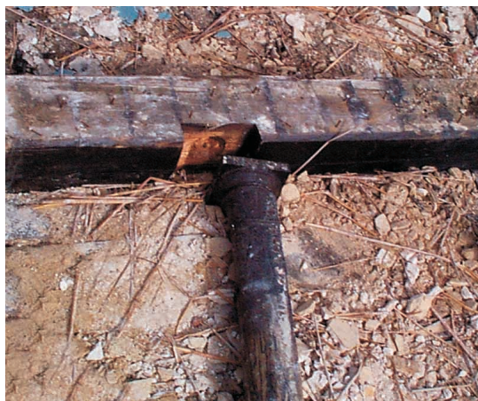
Fig. 7. Da man rev bygningen ned, fandt man foruden de enkelte synlige søjler de oprindelige støbejernssøjler gemt i skillevæggene. Her ses træbjælke og støbejernssøjle. Foto: Anker Ravn Knudsen.
